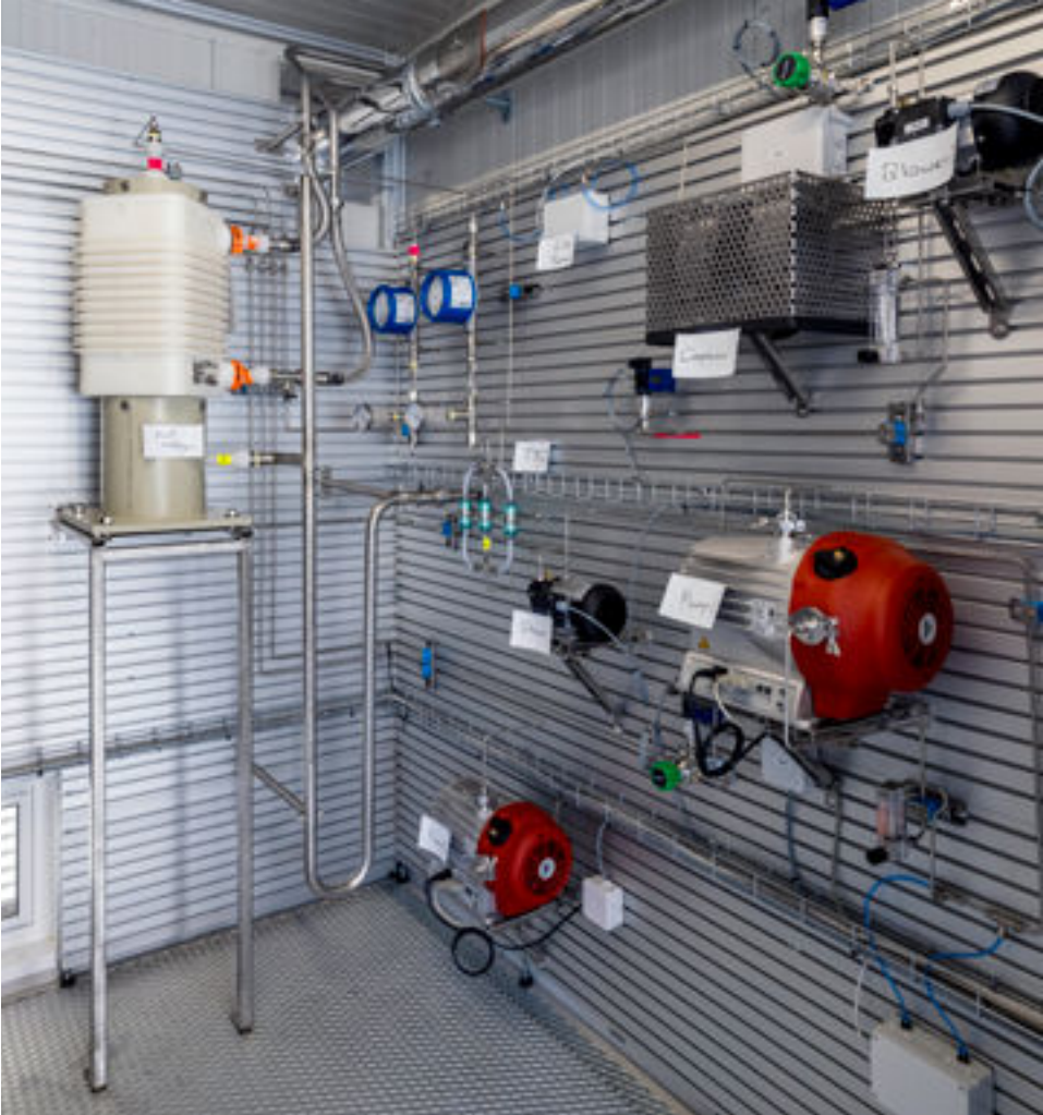
Membranes en graphène à nanopores installées à Aigle dans le cadre du projet GreenGas / @ Jean-Luc Auboeuf.
