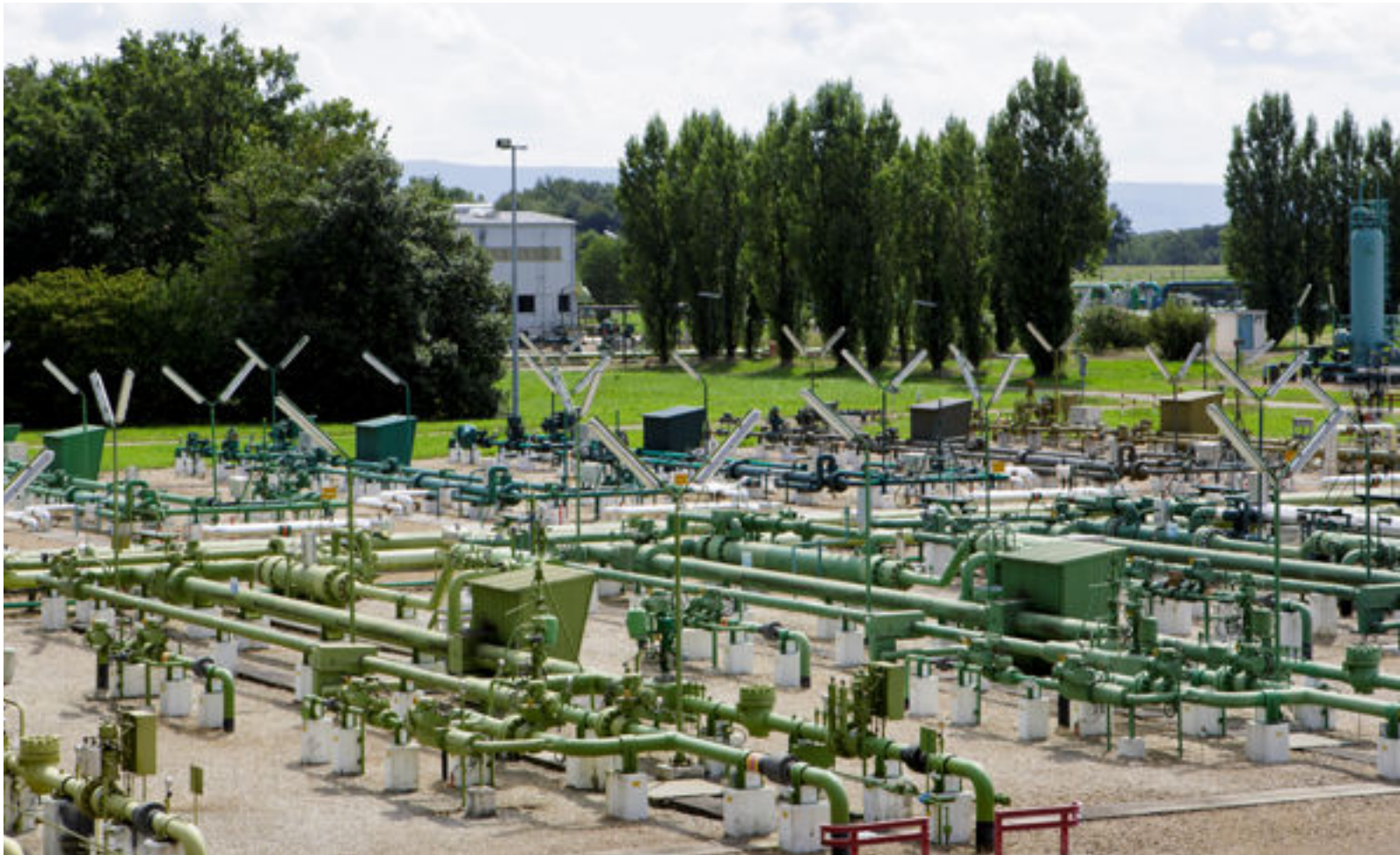
Stockage de gaz souterrain en cavités salines de Storengy, à Etrez, en région Rhône-Alpes @ Storengy.
